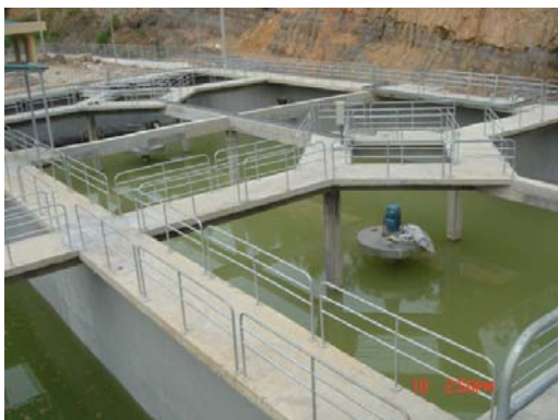
Hình 1.6. Bể SBR số 1
