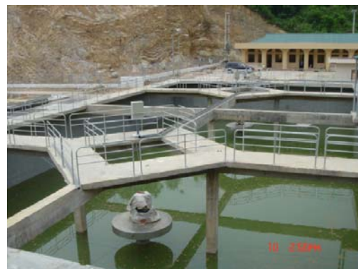
Hình 1.7. Bể SBR số 2
