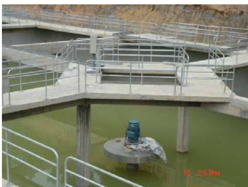
Hình 1.8. Động cơ của máy khuấy ở bể SBR
