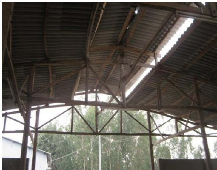
Hình 4.9: Mái nhà hở dễ bị nước mưa tạt vào hầm ủ
