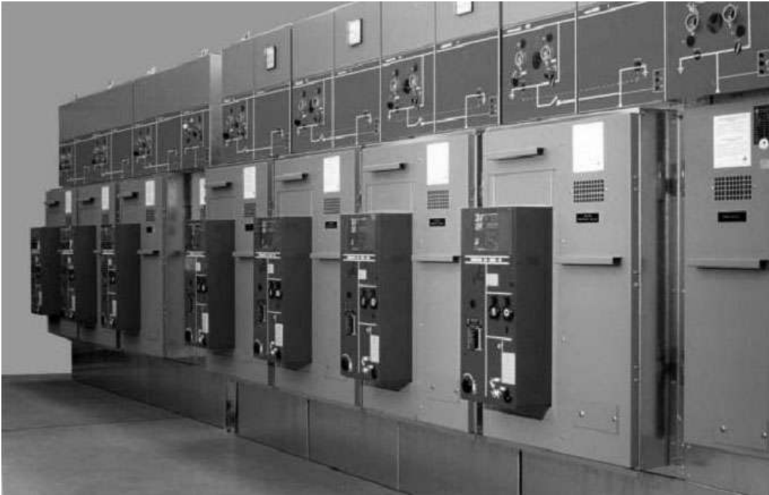
Hình 2.1: Hệ thống tủ hợp bộ trung áp
