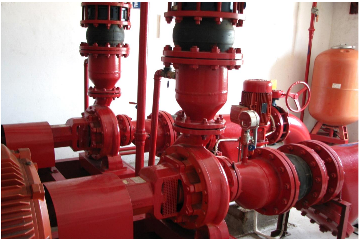
Hình 1.7: Hình ảnh 2 bơm điện số 1 và số 2
