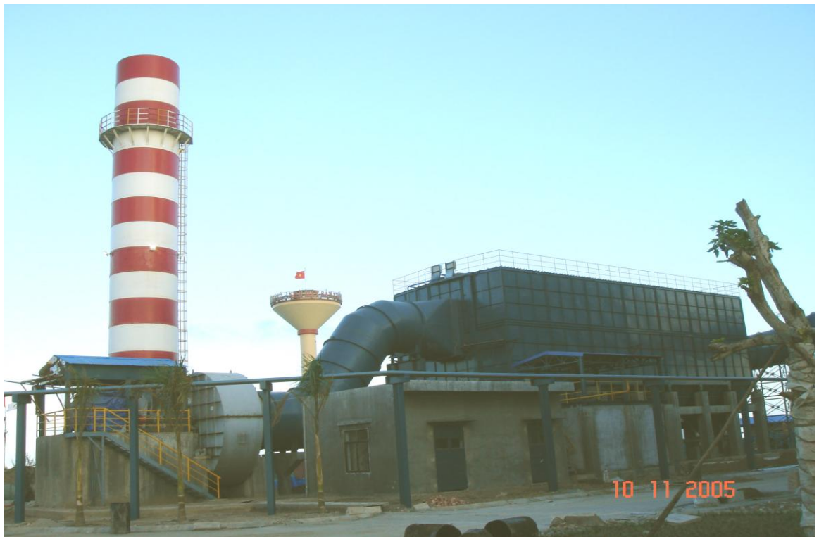
Hình 1.4. Hệ thống xử lý khói bụi
