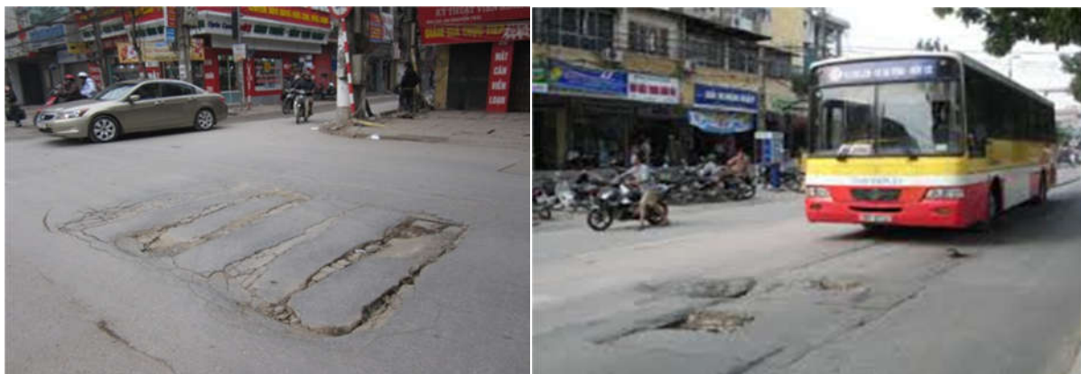
Hình 2.7 Hiện trạng mặt đường
