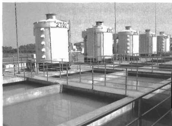
Nhà máy nước Nam Từ mới xây dựng tại Hà Nội
