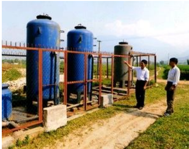
Hệ thống xử lý nước ngầm đơn giản
