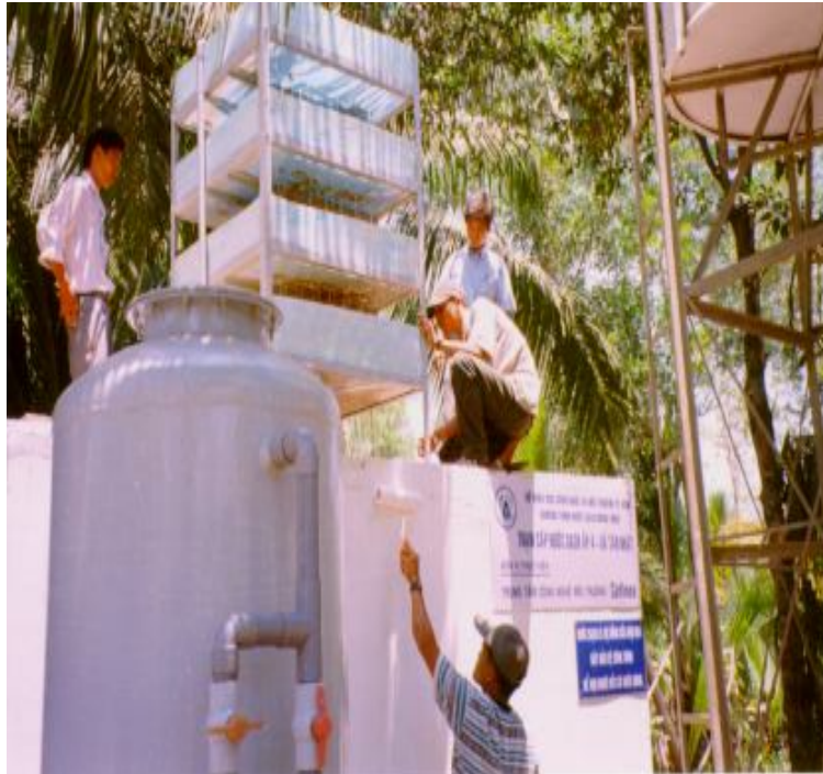
Giàn mưa trong hệ thống khử sắt
