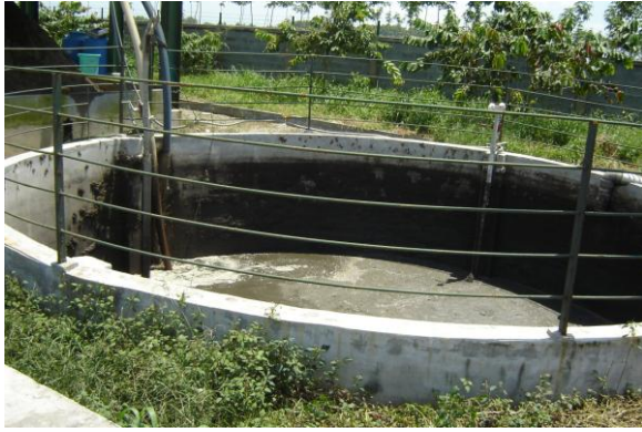
Hình 1. Bể tập kết
