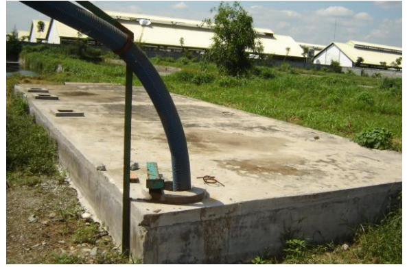
Hình 2. Bể kị khí
